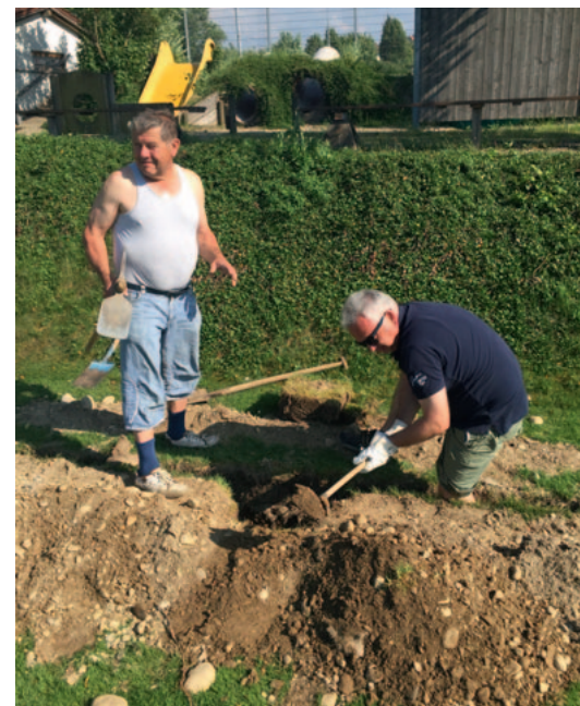
Hubert Wieland und Johannes Fischbach an einer der 24 Beregnungsstationen.
