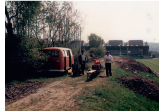
Die Baustelle wird im Mai 1987 von Egbert Heinz und Alois Schill eingerichtet.
